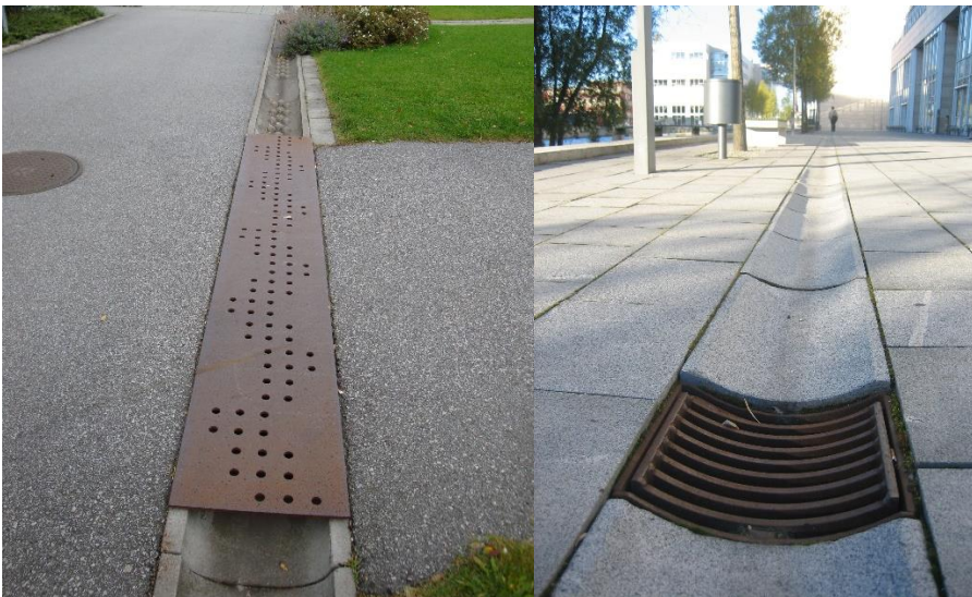
Figur 6-4. Exempel på dagvattenrännor. Foto: Sweco
