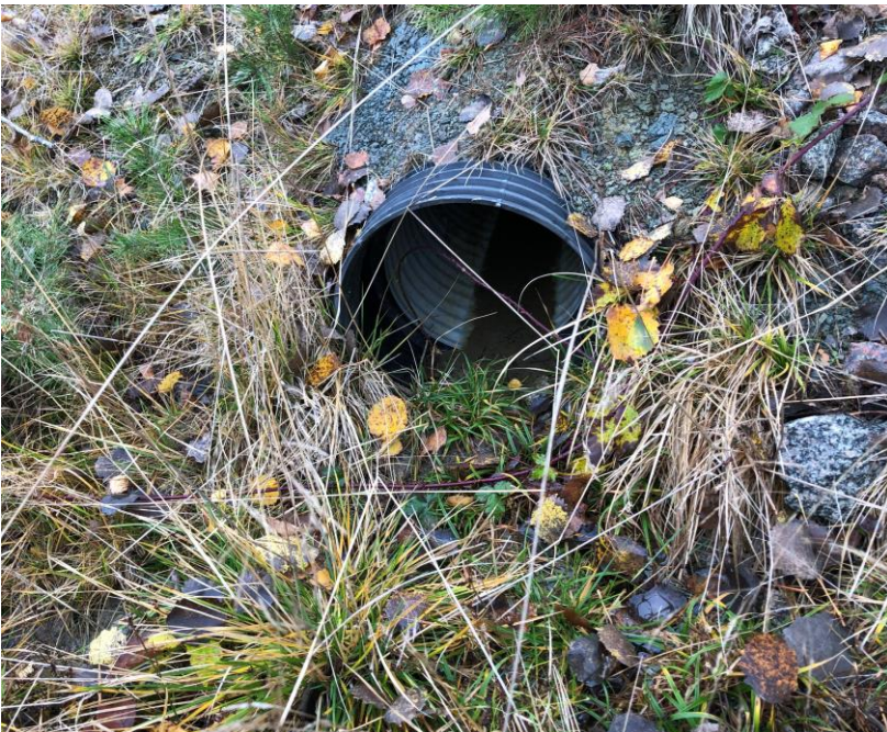
Figur 2-9. Trumma under grusväg. Bildkälla: Sweco
