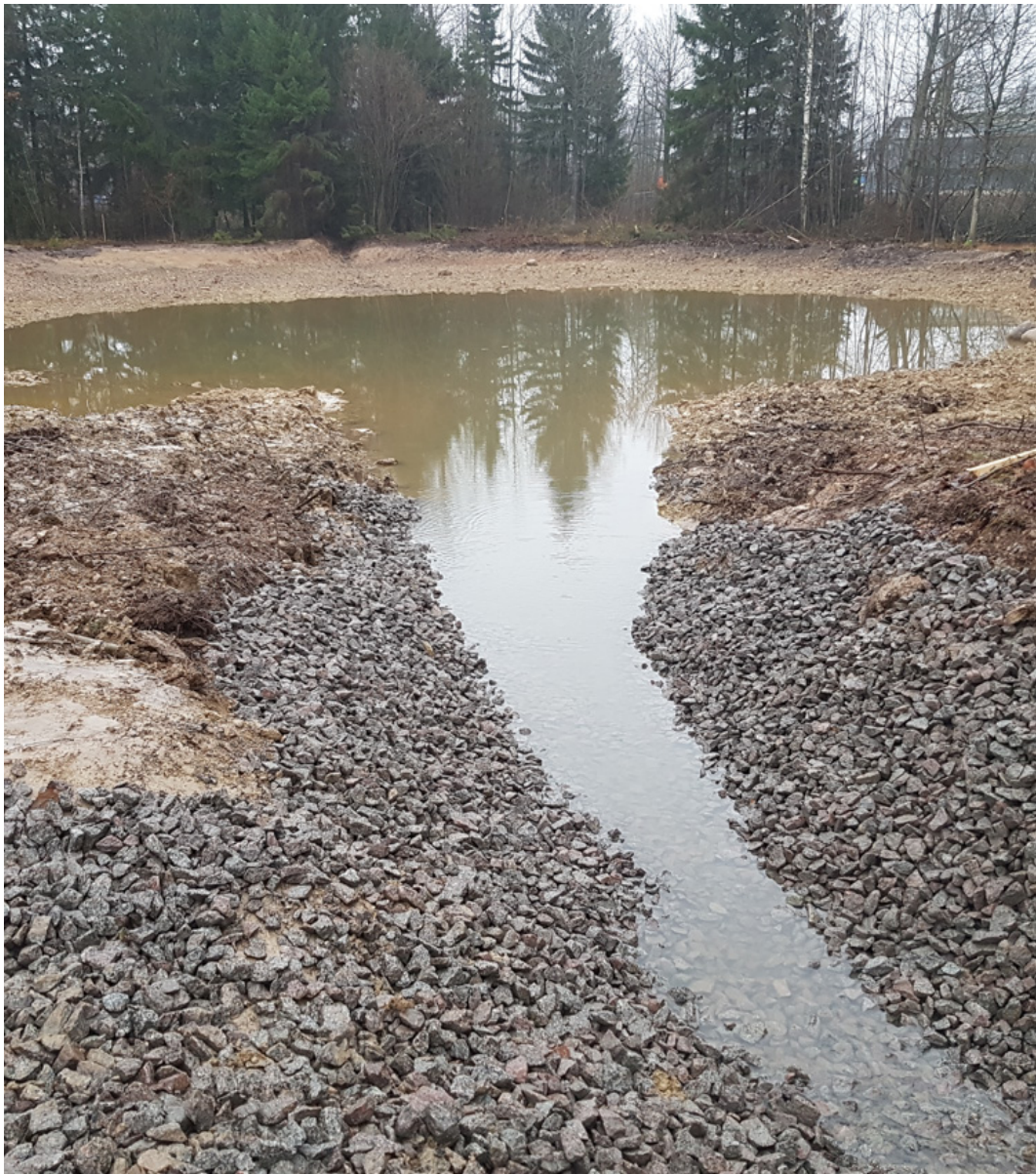
Anlagd dagvattendamm 2019 vid Hållbar plats i Färjestaden. Foto: Michael Ingard
